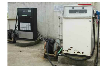
給油設備は軽油とハイオクガソリン、2種類の油種を完備している。
